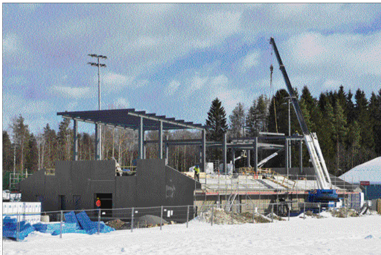
Kankurinpuiston nurmi- ja keninurmikentän väliin on valmistumassa monitoimirakennus, joka toimii sekä katsomona että modernit pukutilat tarjoavana huoltorakennuksena.
